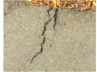
Belagsschäden in Asphalt durch Wurzeln und Erosion
