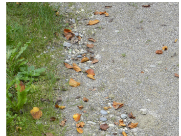
Belagsschäden in Chaussierung durch Erosion
