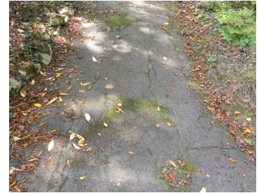
Belagsschäden in Asphalt durch Wurzeln und Erosion
